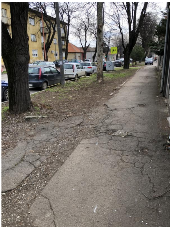
Слика 8. Оштећење на тротоару
